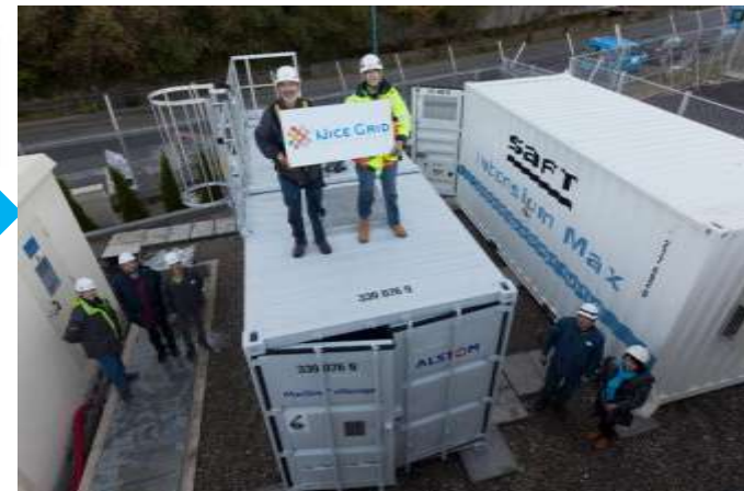
Stockage de 1MW / 560 kWh
