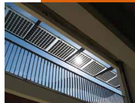
> Capteurs photovoltaïques en brise-soleil
