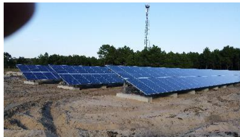
Centrale photovoltaïque au sol sur la station d'épuration de Saint-Julien-en-Born
