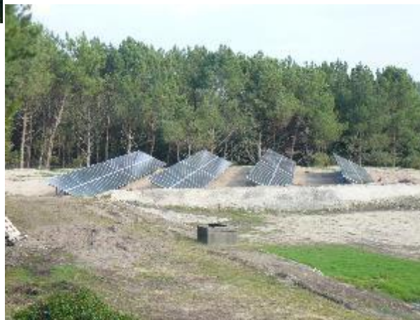
Centrale photovoltaïque au sol sur la station d'épuration de Léon
