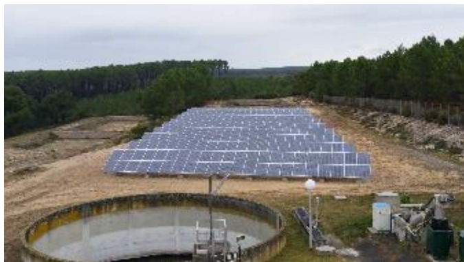
Centrale photovoltaïque au sol sur la station d'épuration de Vielle-Saint-Girons
