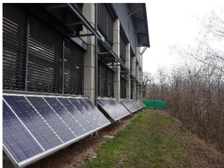
Halle de Gymnastique 10 kWc – 2007 – Vente Totale
